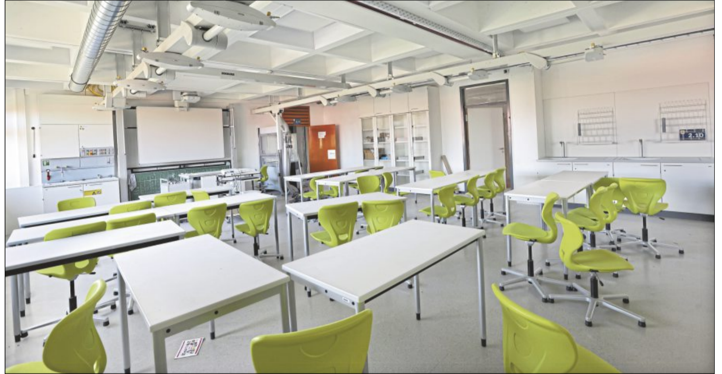
Die letzten Fachräume an der Schule, die noch sanierungsbedürftig waren, wurden jetzt angegangen.
